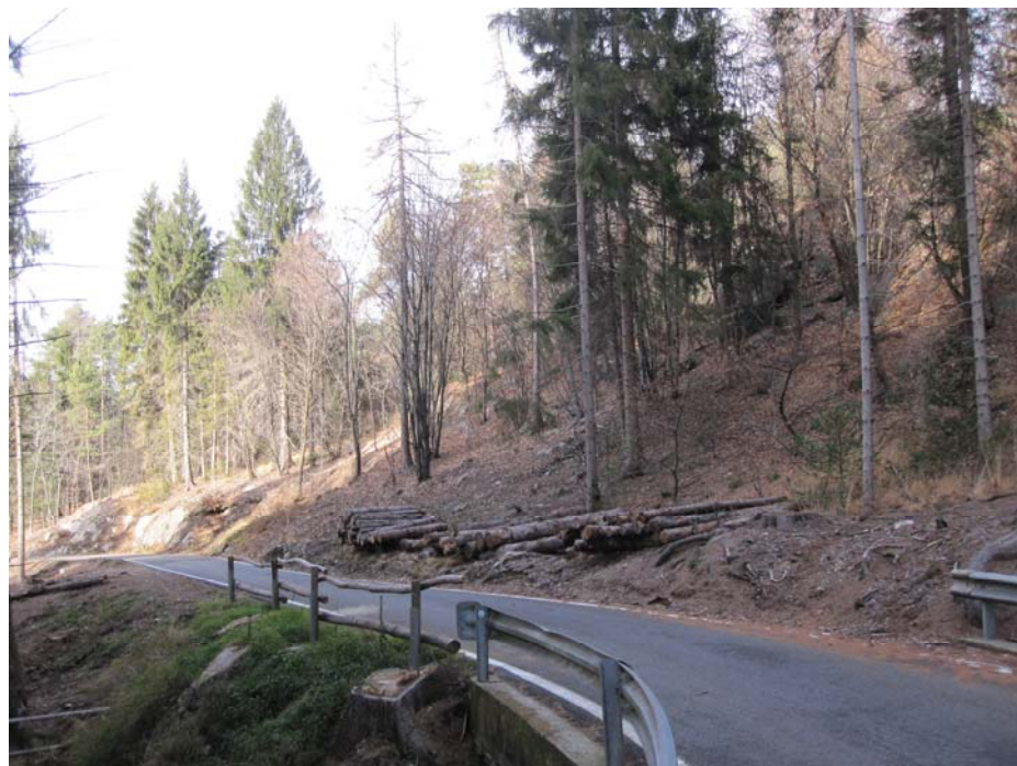
Fotografia 2: Strada potenzialmente interessata da crolli provenienti dalla parete di fotografia 1.
