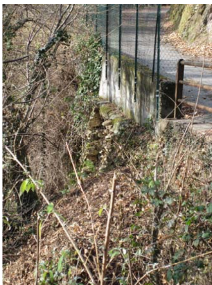
Fotografia 5: crollo del muro in sassi di sostegno al muro in C.A.
