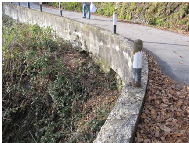
Fotografia 6: scivolamento dei terreni sottostanti il muro di sostegno del corpo stradale
